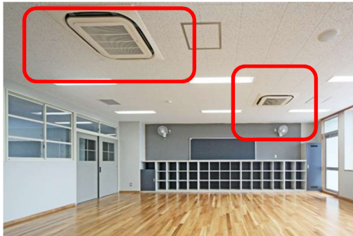
上尾中学校の教室エアコン
