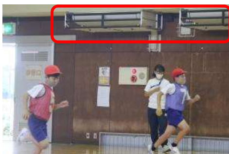
体育館のエアコン
