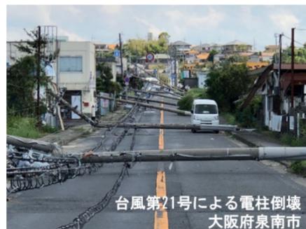
台風により倒壊した電柱
