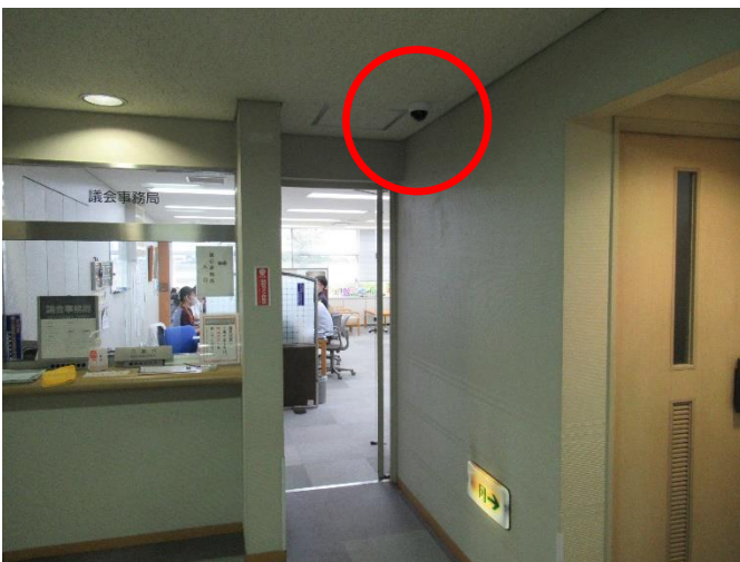
防犯カメラの設置（議会棟）
