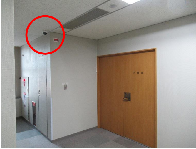
防犯カメラの設置（3階）
