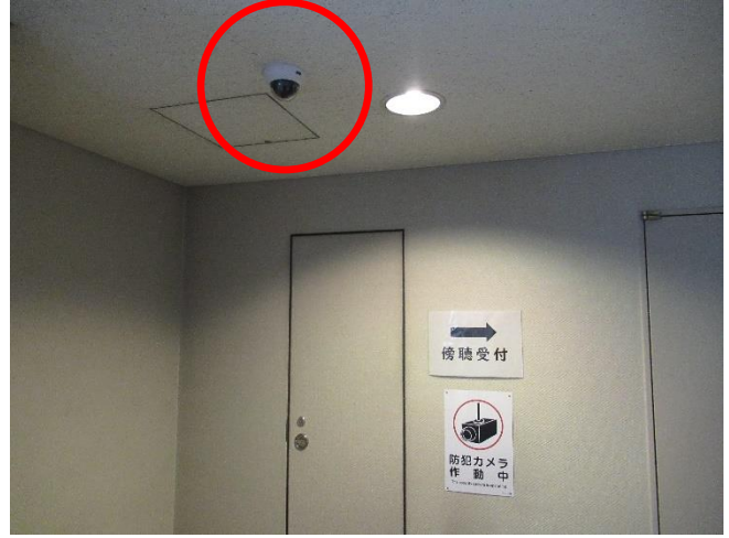
防犯カメラの設置（議会棟）
