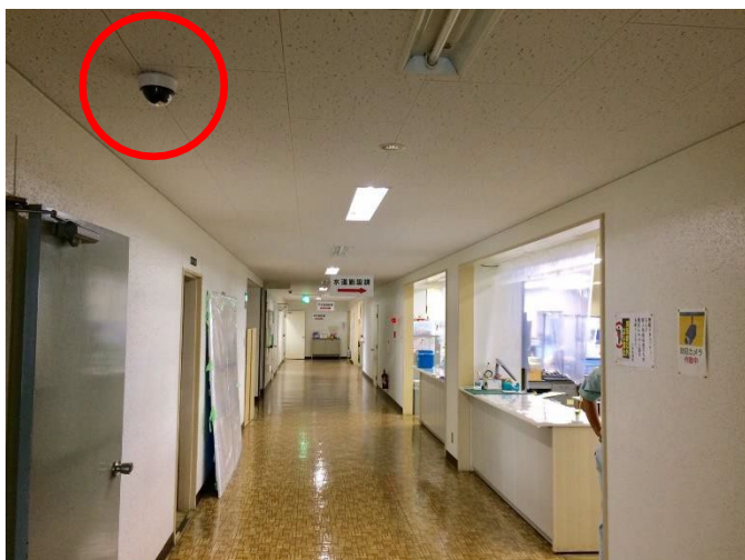
防犯カメラの設置（水道施設課）
