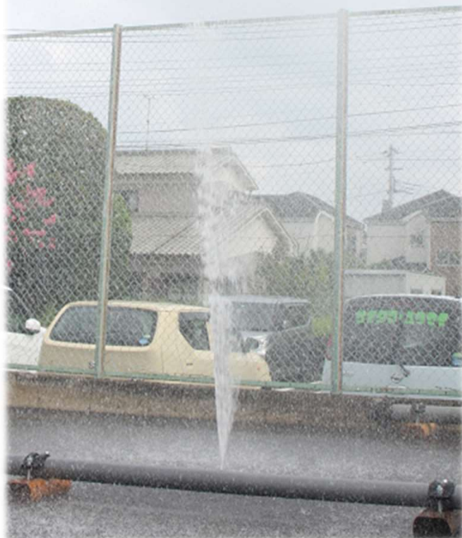
《破損を想定した水道管の漏水状況》
