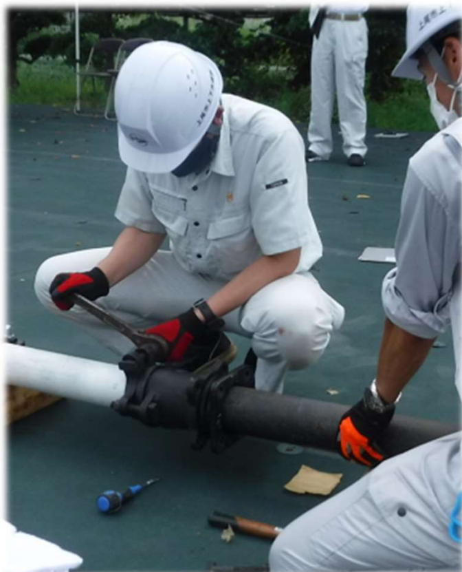
《ボルト締め込み(破損側)》
