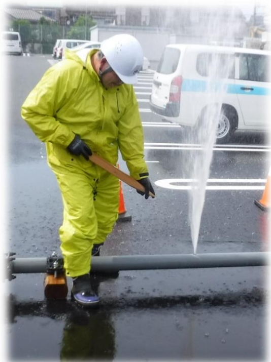
① 漏水箇所の確認
