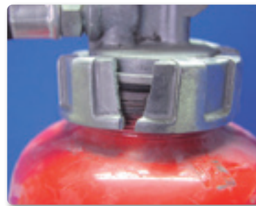
使用に耐えない破損
