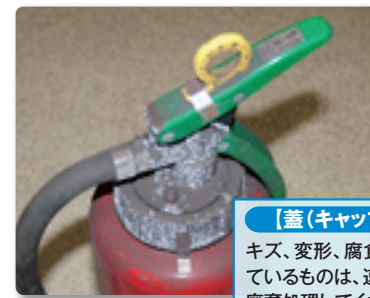
あばた状の腐食
