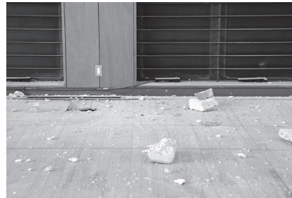
市民体育館の被災状況
