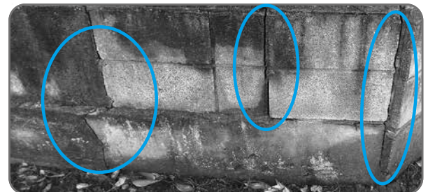
ひび割れの例
