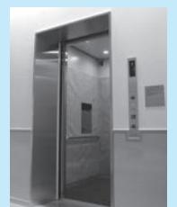
2階エレベーター
