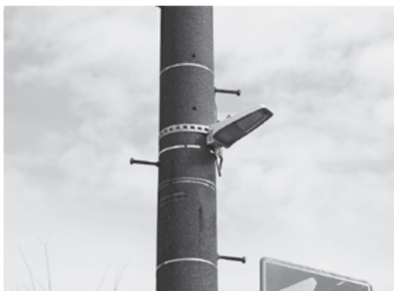
LED化された道路照明灯
