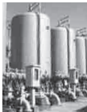
取材した東部浄水場のろ過機
