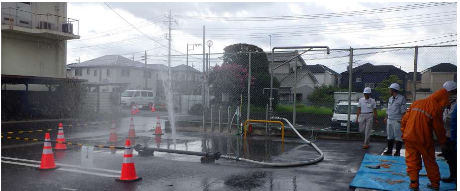
9.漏水（想定）箇所全景
