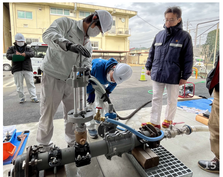
穿孔機を使用し 铸铁管に直径50mmの 給水管取り出し孔を開ける
